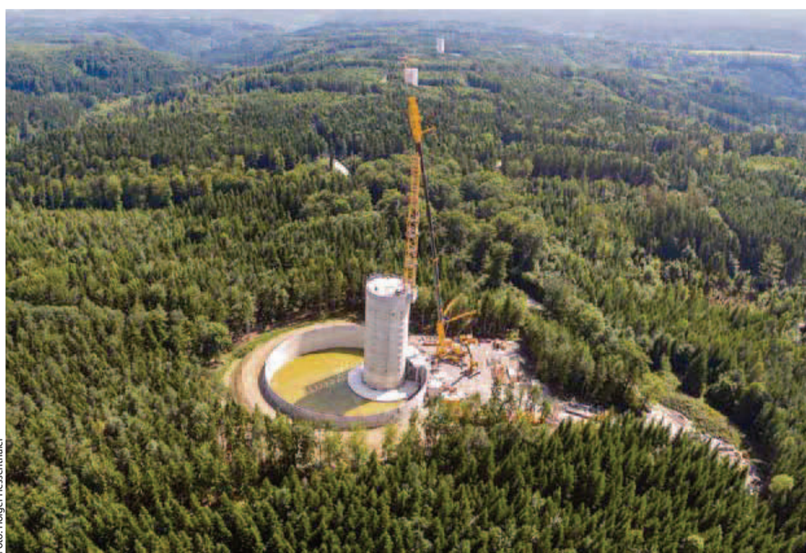
In Gaildorf baut Max Bögl die flexible Wasserbatterie: Ein Windpark kombiniert mit einem Pumpspeicherkraftwerk.
